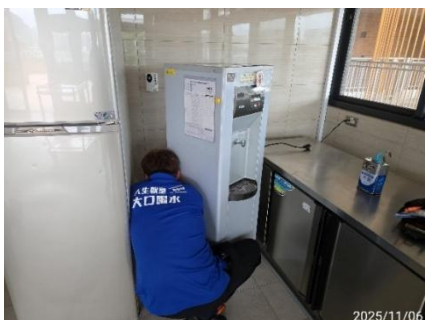
▼已故障的飲水機
